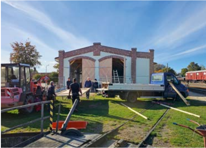
Gleich am Montag nach Ende der Sommersaison begann der Einbau der Schuppentore des neuen Lokschuppens in Bruchhausen-Vilsen. Diese kamen vorgefertigt aus der Zimmerei an und wurden nach Anbringen der Befestigungselemente und Scharniere am Stück montiert. 07.10.2024
