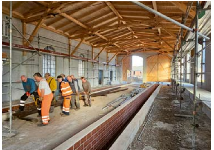
Im Rahmen der herbstlichen Gleisbauwoche wurden die Schienen, die für die Grubengleise des Lokschuppens vorgesehen sind, aus Heiligenberg geholt. Vom Gleis in den Lokschuppen hinein wurden sie dann Schiene für Schiene mit Muskelkraft „unter Dach“ gebracht. 22.10.2024
